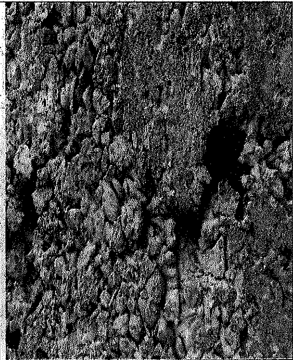
Fotografía N° 6, acercamiento nido de piedra muro patio 1, módulo de reclusión tipo rac, eje 9, entre ejes M y L (Nivel 1). 25 de mayo de 2017.
