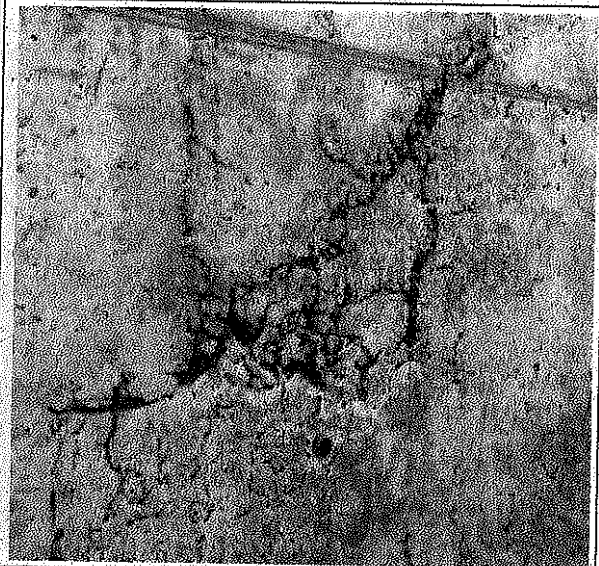
Fotografía N° 4, acercamiento muro patio 1, módulo de reclusión tipo rac, eje M, entre ejes 1 y 9 (Nivel 1). 27 de abril de 2017.
